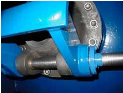
Del deflector de chorro en posición para desviar el chorro de agua lejos de la turbina.
