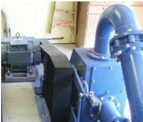
Accionamiento por correa de acoplamiento entre la turbina y el generador.
